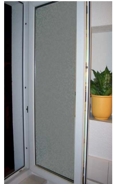
Komplett beschlagene Fensterscheibe am Anfang des Lüftungsvorganges.
