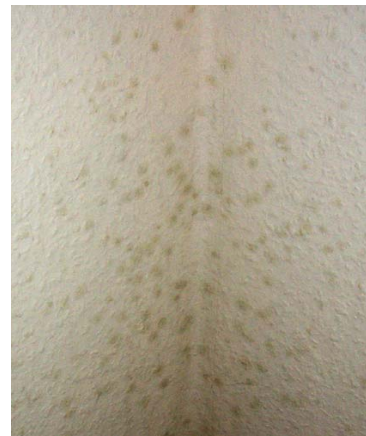
Stockflecken an Zimmeraußenwänden
